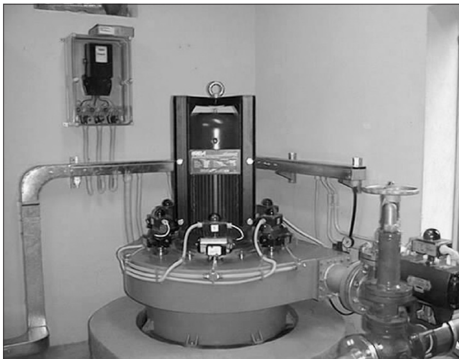
Microcentrale idroelettrica Ecowatt installata a Chiomonte.
